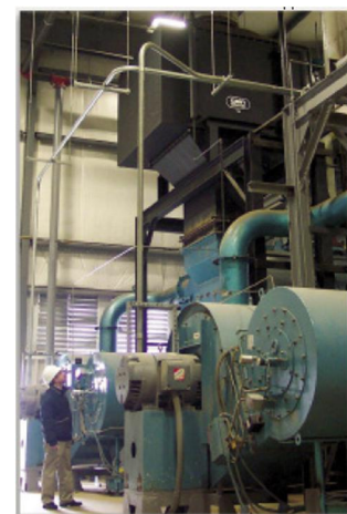
การเชื่อมต่ออุปกรณ์ทำน้ำร้อนที่ปล่องไอเสีย ของหม้อไอน้ำ
